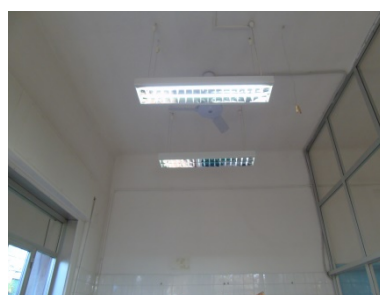
Figura 8.8 - Particolare impianto illuminazione su cui intervenire.
