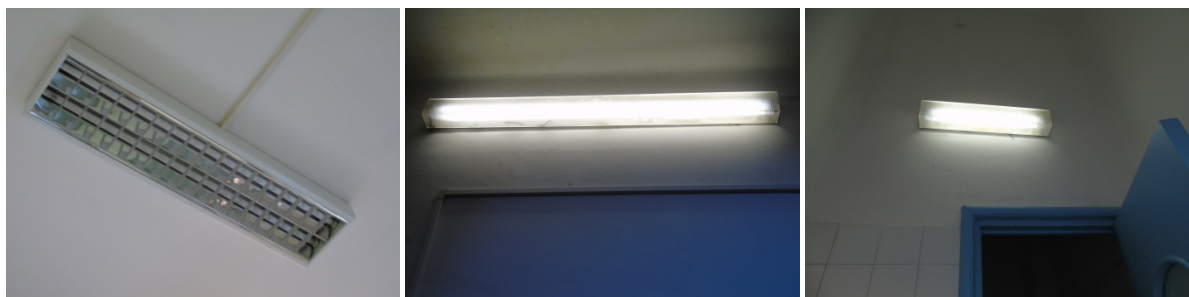
Figura 4.13 - Particolare dei corpi illuminanti
