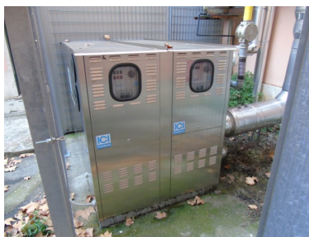
Figura 4.11 - Generatore di calore
