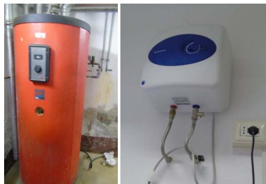
Figura 4.12 - Particolare dell'accumulo in centrale termica e del boiler elettrico per la produzione di acqua calda sanitaria
