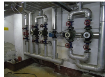
Figura 8.6 – Particolare sistema di distribuzione
